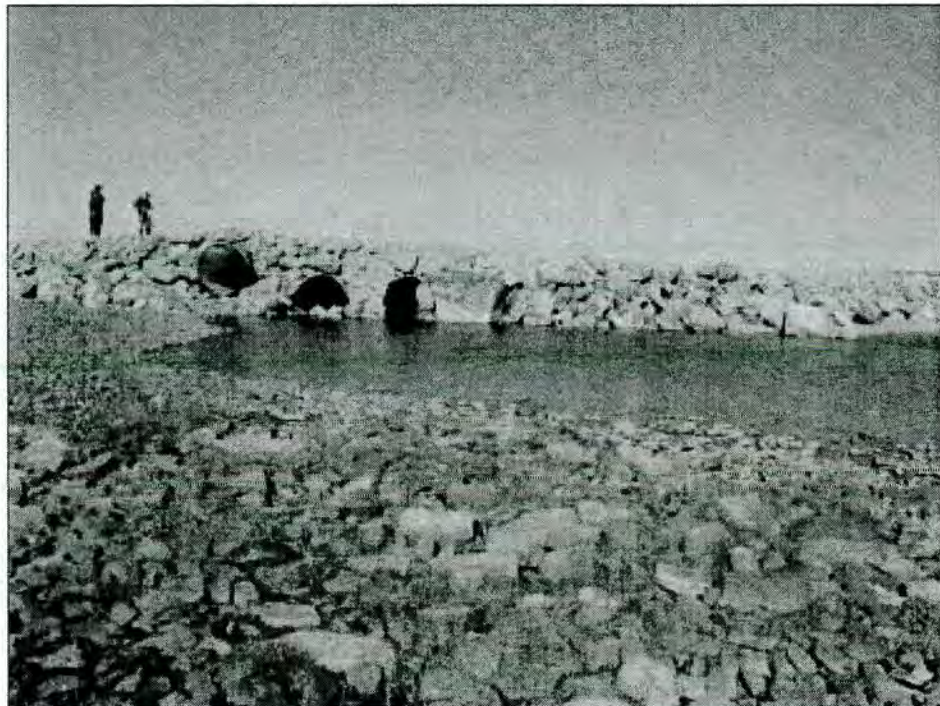
PHOTO 10 Exemple de ponceaux multiples (route existante reliant le site Mesamax et l'aéroport de Donaldson).
